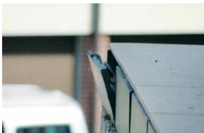
Nieodpowiednie wykończenie krawędziowe – odpadanie płytek czołowych.
