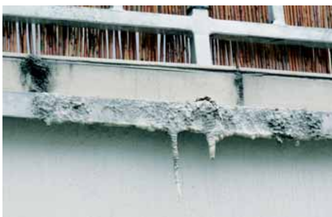
Brak uszczelnienia – wyłukiwanie składników betonu i zapraw.
