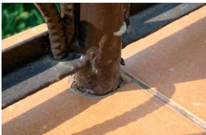
Przecieki przy elementach przebijających powłoki hydroizolacji.
