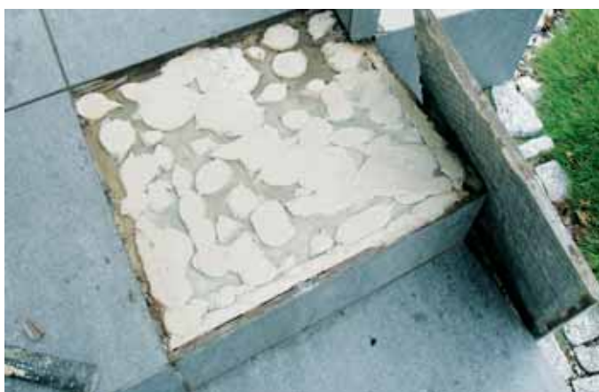
Niewłaściwe nałożenie warstwy kleju o niskich parametrach – odspajanie się i pękanie płytek.
