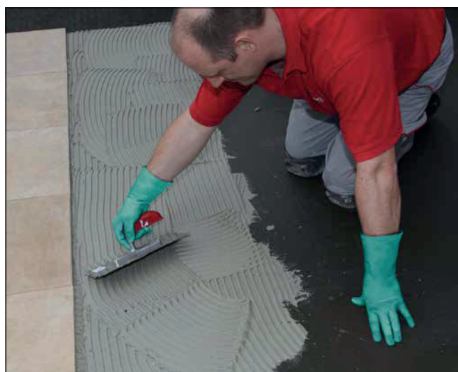
16 Na wyschnięte uszczelnienie nałożyć wysokoelastyczną dwuskładnikową zaprawę klejową S2 Sopro MEG 665 lub wysokoelastyczną dwuskładnikową zaprawę klejową szybkowiążącą S2 Sopro MEG 666
