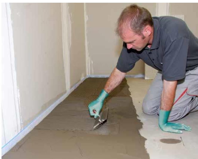
9 Jeżeli podłoże drewniane jest równe, bezpośrednio na preparat gruntujący Sopro HPS 673 nałożyć zaprawę klejową np. Sopro No.1 400 w celu przygotowania powierzchni pod płyty izolacyjne Sopro FDP 558.
