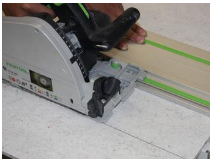
11 Obróbka i cięcie płyt izolacyjnych Sopro FDP 558 jest możliwe, np. przy użyciu wyrzynarki.
