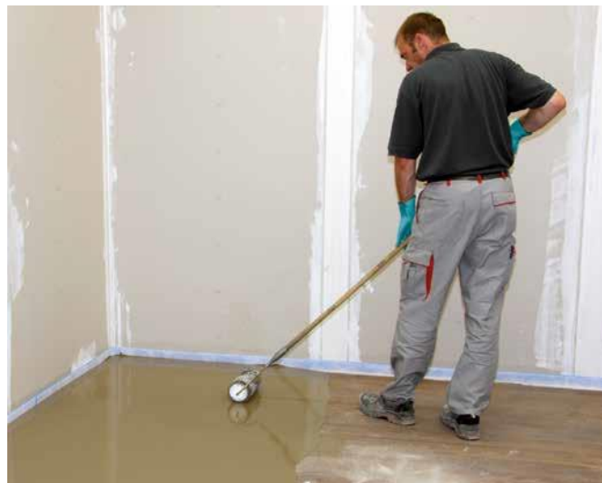
8 Masę szpachlową Sopro FLOOR WS 3.70 extreme rozprowadzić i odpowietrzyć przy pomocy walca z kolcami, aby uzyskać równą powierzchnię podłoża.
