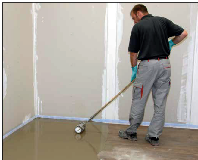
8 Szpachlę Sopro FAS 551 rozprowadzić i odpowietrzyć przy pomocy walca z kolcami, aby uzyskać równą powierzchnię podłoża.
